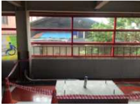
<충전기 설치전 전경(실내)>
