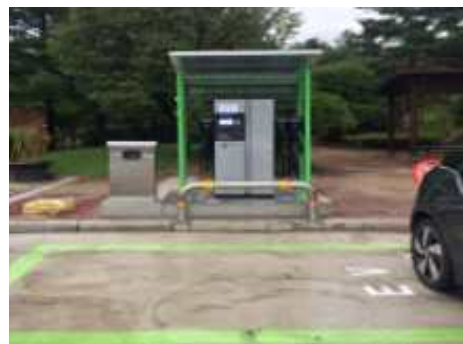
<충전기 설치후 전경(실외)>
