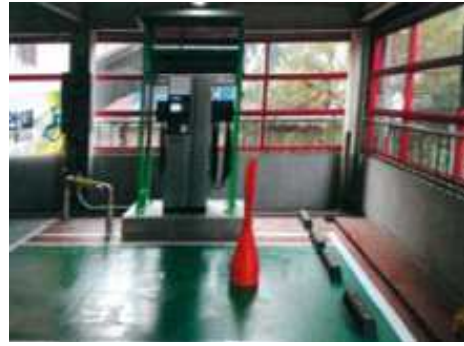
<충전기 설치후 전경(실내)>
